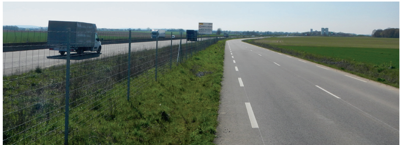
Itinéraire de substitution créé le long de la RN2 à Vaumoise (Oise). ©DREAL Hauts-de-France.
